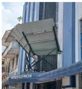
Sistema de contención de fachada frontal y central de la Agencia de San Felipe.
